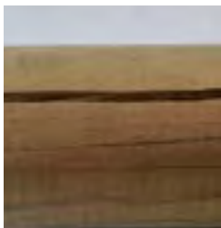
Cracks/Grietas/Fente/Risse/ Crepe/ Barsten/Fendas
